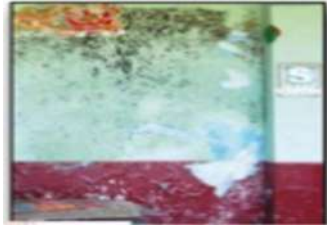
Muro con problemas de humedad
