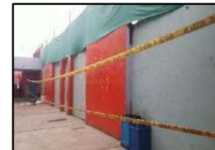
Cerco perimétrico de ladrillo presentarajaduras
