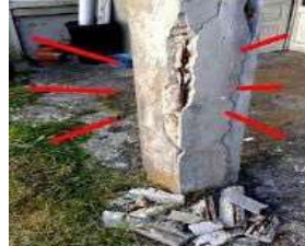
Columna con grietas
