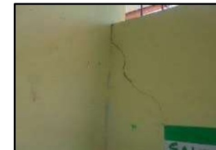
Pared presenta rajaduras
